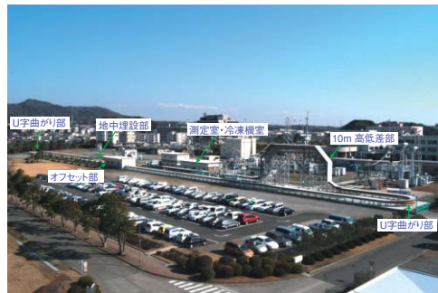
500m高温超電導ケーブルフィールド 試験線路
