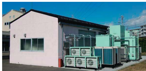
ヒートポンプ性能評価試験設備
