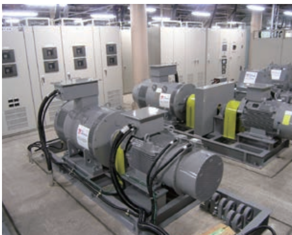
火力発電機(4,5号機)模擬装置一式
