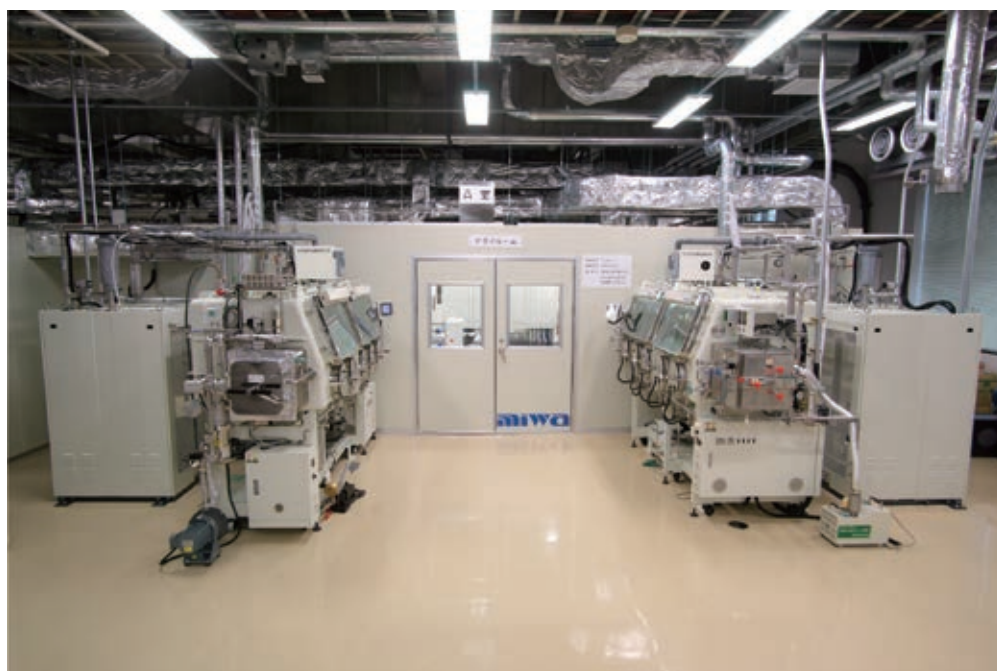
電池性能評価・材料調製基盤設備
