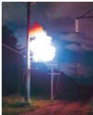
20~30kV配電実験設備(S44年・赤城)
