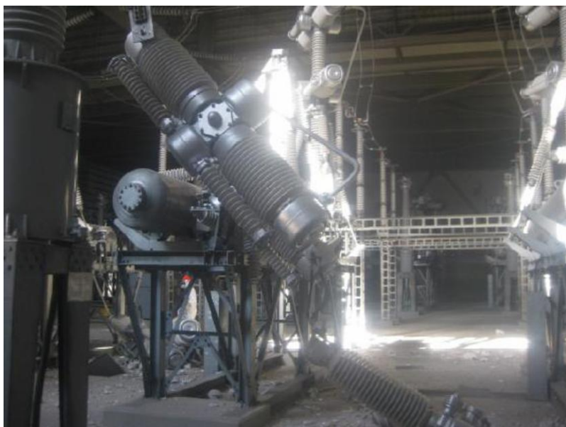
地震による被害の例（開閉所遮断器損傷）
