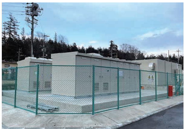
赤城試験センターのマイクログリッド主電源設備実証試験設備
