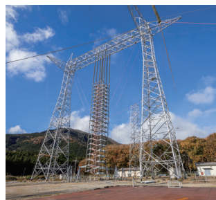
衝撃電圧発生装置
