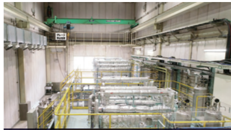
火力給水処理試験設備
