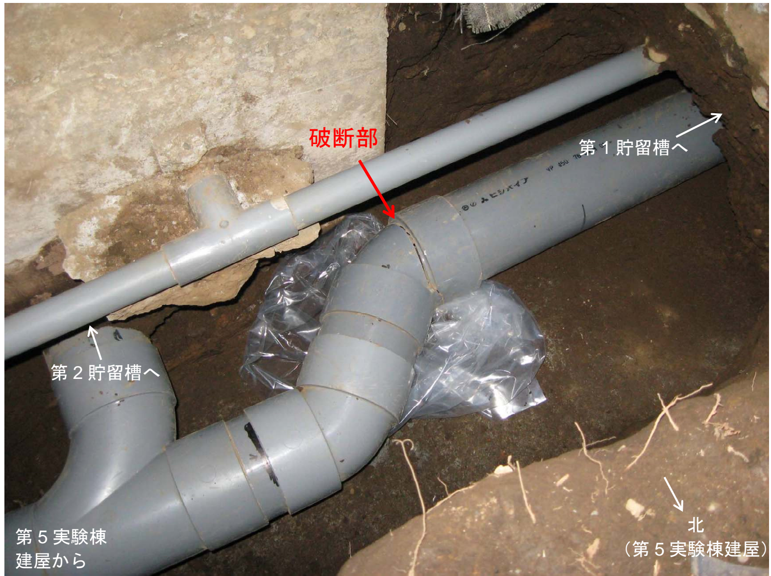
図 4 第5実験棟屋外配水管の破断部外観
