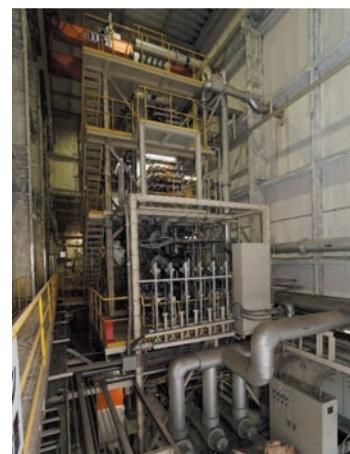
石炭燃焼特性実証試験設備
