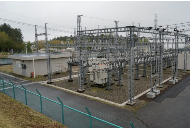
赤城変電所 当所赤城試験センター専用の変電所で、需要地系統ハイブリッド実験設備の実験用変電設備としても活用しています。
