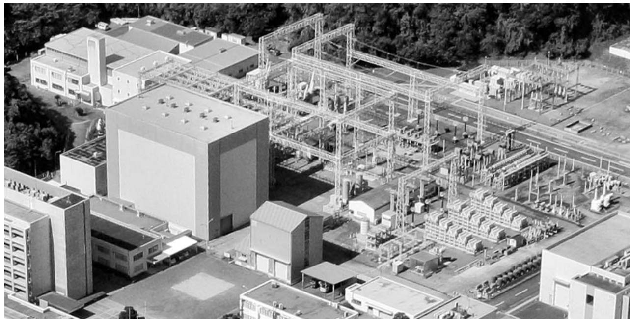
大容量電力短絡試験設備の全景。横須賀地区にあり、1963年に設置された。
